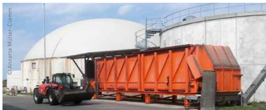
Viele Tiere machen viel Kot. Dieser wird in der eigenen Biogasanlage ökologisch sinnvoll verwertet.
